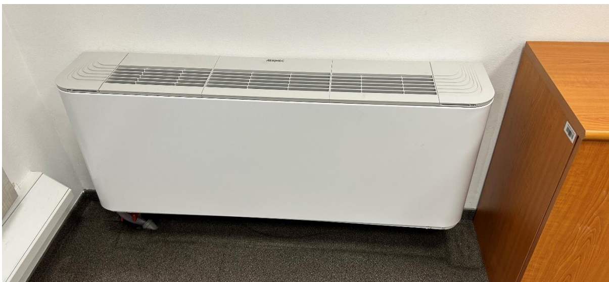
Slika 70: Novi hladilno-ogrevalni konvertorji
