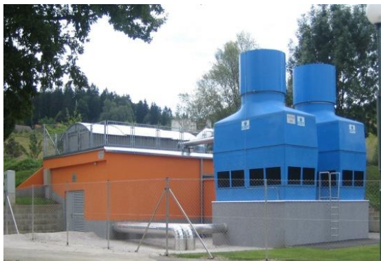
Slika 15: Zunanji izgled hladilne postaje
