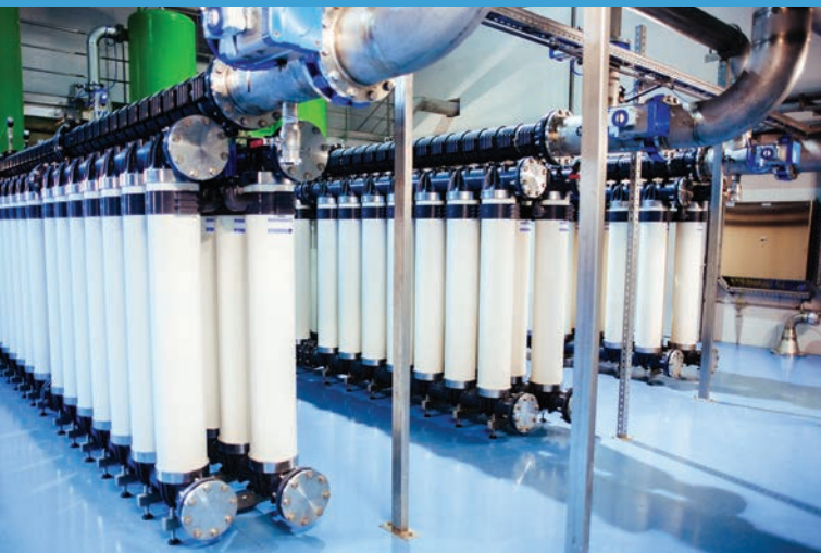
Ultrafiltracijske enote na napravi za pripravo pitne vode Grmov vrh
