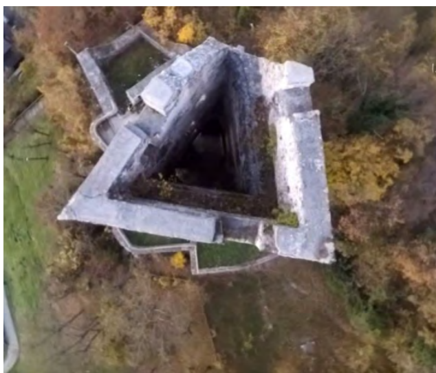
Pogled iz zraka na vrh stolpa z armiranobetonsko krono - morda je v levem kotu že nekaj razpok – obvezno je stalno spremljanje ruševine. 360
