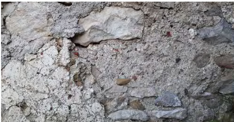
Zdrobljena opeka v malti grajskih zidov.
