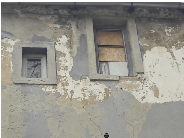
Okvirji stranišnega dela so samo 'nalepljeni' na fasado.
