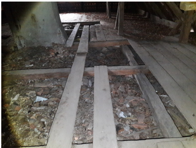
Nasutje na podstrešju je potrebno odstraniti in nadomestiti z lahko zvočno izolacijo.
