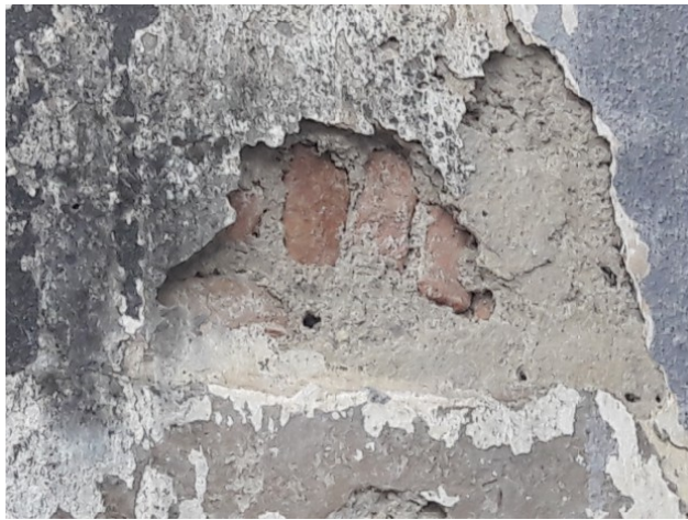
Opečni lok v fasadi – je pod njim zazidano okno?
