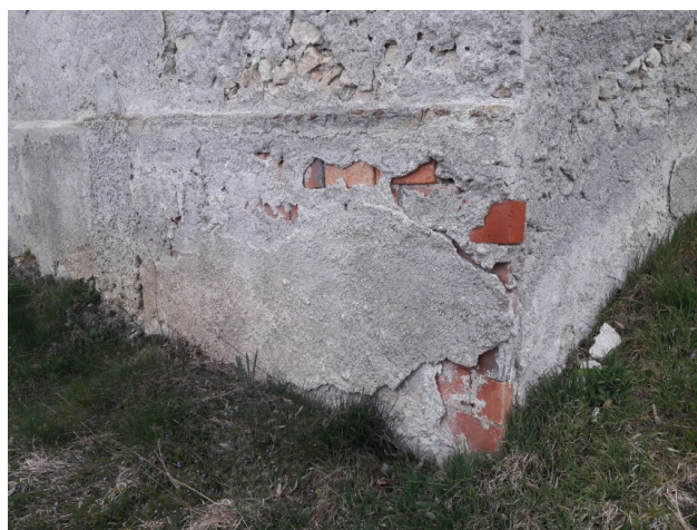
Opečni podzidek (cokl) je sekundarno 'nalepljen' ob starejši zid iz apnenčastih lomljencev.
