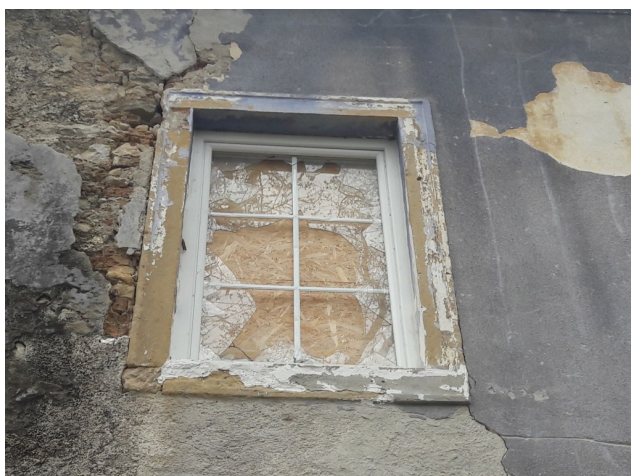
Okna prvega nadstropja imajo plitvo profilirane okvirje iz rumenega peščenca. Opečna zazidava špranje med okvirjem in siceršnje kamnito zidavo zidu priča, da so bila okna kasneje vstavljena v osnovni zid. Izpod oluščene ometa se kažejo ploskve predhodnega beleža, skladnega z imenom Beli dvor. Tudi na okvirjih so ostanki prejšnjih temnejših poslikav.
