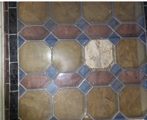
Potrebna je rekonstrukcija zasteklitve
