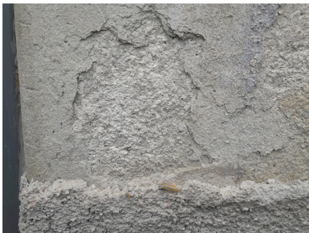
Serija ometov na zunanščini – cementni obrizg se vsekakor odstrani, izvajajo se ometi na apneni osnovi.
