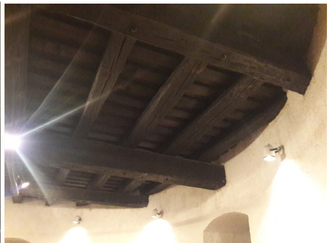
Kompleksen sestavljen strop rondela, nad njim je novejša betonska plošča. Leseni del naj bi bil obešen na ploščo.
