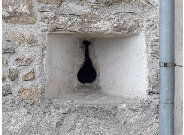
Strelnica v spodnji etaži rondele. Zakaj je ostenje strelnice ometano, preostala površina pa samo široko fugirana? Nelogično. S Stoparjeve fotografije iz 1968 je razvidno, da je bilo pred prenovo vse ometano.
