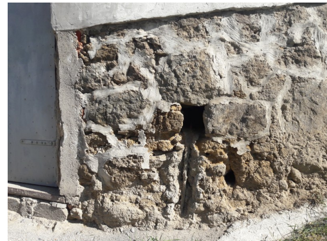
Lina okroglega stolpa desno od vhoda v najnižji etaži. Iztekajoča malta. Lina je zamrežena s pokončno kovinsko palico. Dotrajano široko fugiranje – prefugirati.
