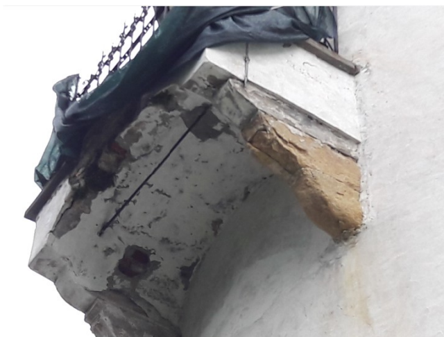
Razpadajoče konzole in obok balkona pred prenovo
