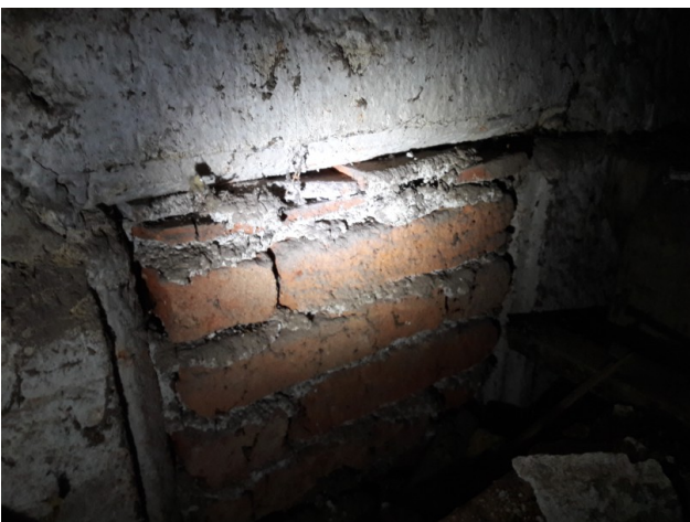
Tretje zazidano okno, južni del iste fasade.
