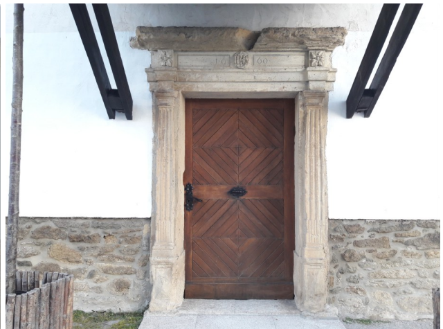
Portal kapele. Recentni opori nadstreška – podvojeni rezani profili z vmesnimi spojnimi kosi.
