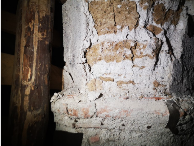
Vertikalno razpokan lehnjak obočnega nastavka in odpadajoči omet kažeta, da steber na tem delu morda ni več sposoben prenašati obtežb in bodo potrebne okrepitve konstrukcije – po navodilih statika in ZVKDS
