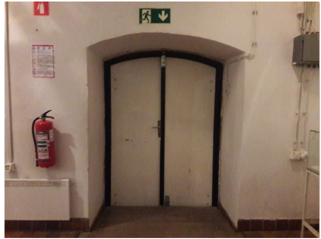
Vrata in nadometne instalacije v sobi Mastodont
