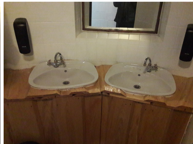
Obdelava pultov sanitarij z deskami. Je niša z ogledalom ostanek nekdanje okenske niše?
