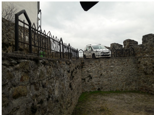
»Dvorišče« je v resnici etaža nekdanjega servisnega objekta – območje je bilo zaprto / zastrešeno. Zavajajoč vtis, nefunkcionalna ograja.
