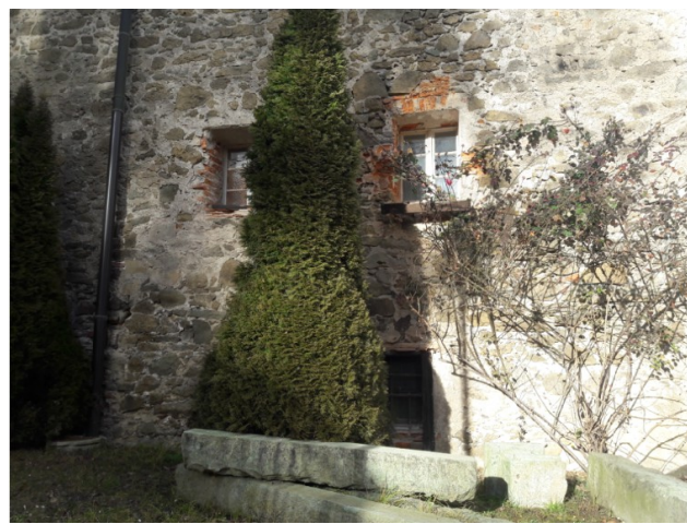
Tri okna v obzidju levo od vhodnega stolpa: opečna ostenja kažejo, da gre za kasnejše interpolacije / prebitja zidu
