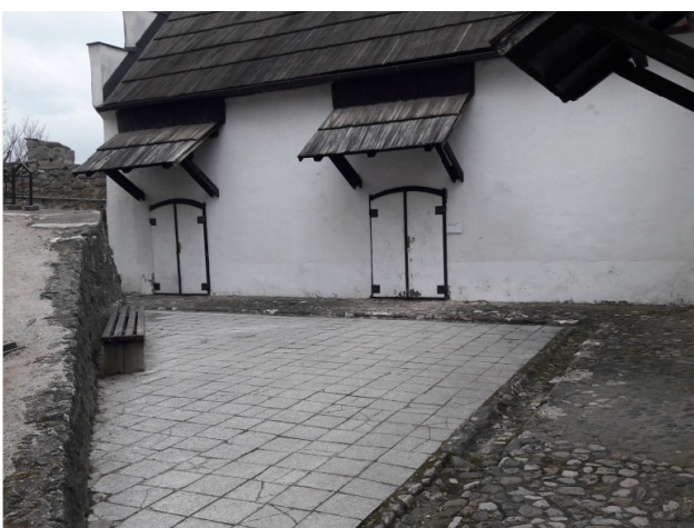
Dvorišče pred zbirko Mastodont: tlak iz teraco plošč in neavtentični nadstreški, zid brez ograje
