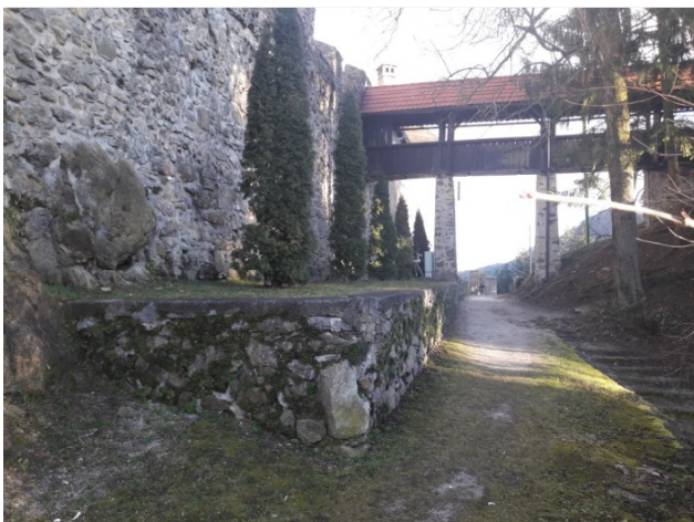
Škarpa v nekdanjem grajskem jarku – nanjo so bile postavljene lope, prislone ob obzidje, potem razstavišče jamskih podporij. Samovoljno = brez koncepta sajena drevnina (kleki – 'ciprese') slabi likovni vtis območja (zakriva obzidje). Drevnina in škarpa sta namenjeni za odstranitev, da se ponovno očisti / vzpostavi grajski jarek.
