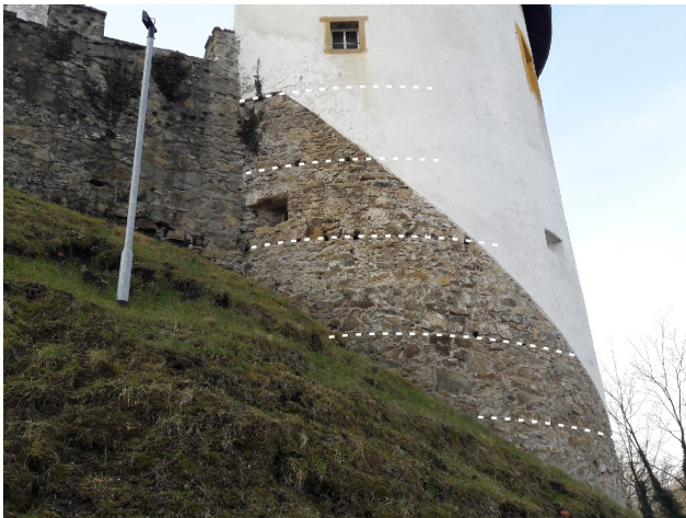
Dnevnice, ki jih označujejo brunčnice. Na nivojih, označenih s črtkanimi linijami, so bili postavljeni zidarski odri na tanjših okroglih debelih, ki so ležala prečno preko zidu in so jih po gradnji požagali. Sprhnela debela so pustila v zidu okrogle sledi.
