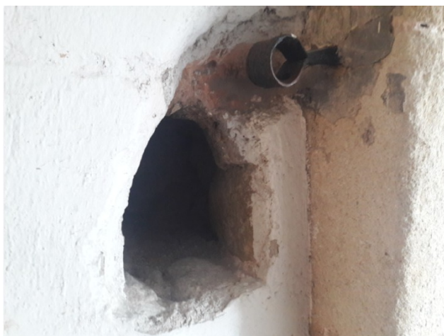
Odprtina za tram, ki dodatno učvrsti vrata, v levem ...
