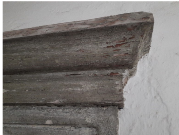
Pobarvana lesena profilacija levega portala posnema kamniti portal desno. Temnejša siva barva, kakršna se pojavlja v ostankih tudi na posameznih stebrih – ostanek nekdanje barvne sheme?
