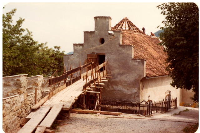
Dostop v rondo ob obnovi preko območja nekdanjega servisnega objekta – tako je nabrž funkcionirala tudi dostava materiala za obrambo v vrhno etažo rondele (vrela voda, smola, kamenje ...), kar so metali in izlivali iz rondele.
