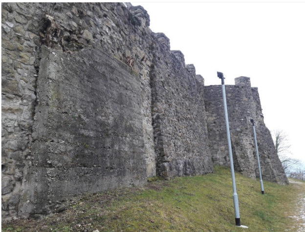
Večkrat dodatno podprto severno obzidje. Betonska izvedba je problematična.
