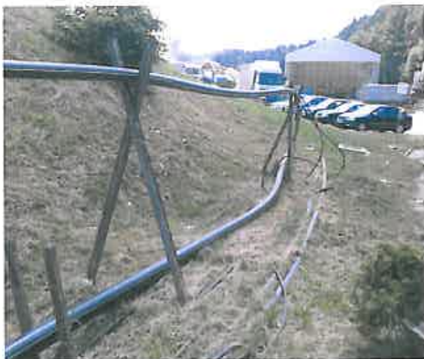
Slika 5: Plinske cevi - nadzemno
